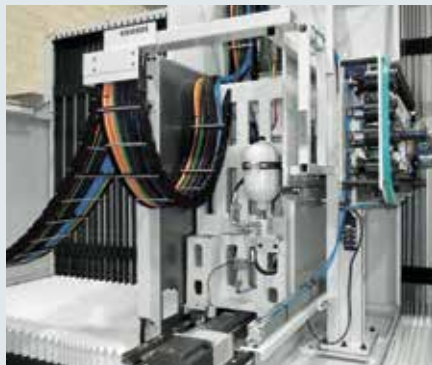
■ Affidabilità grazie ad una corretta impiantistica. Reliability thanks to a well done plant design.
